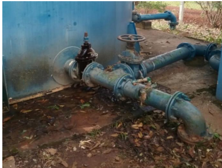
Vazamento em Reservatório de Água Município de Jaguariúna - 2016
