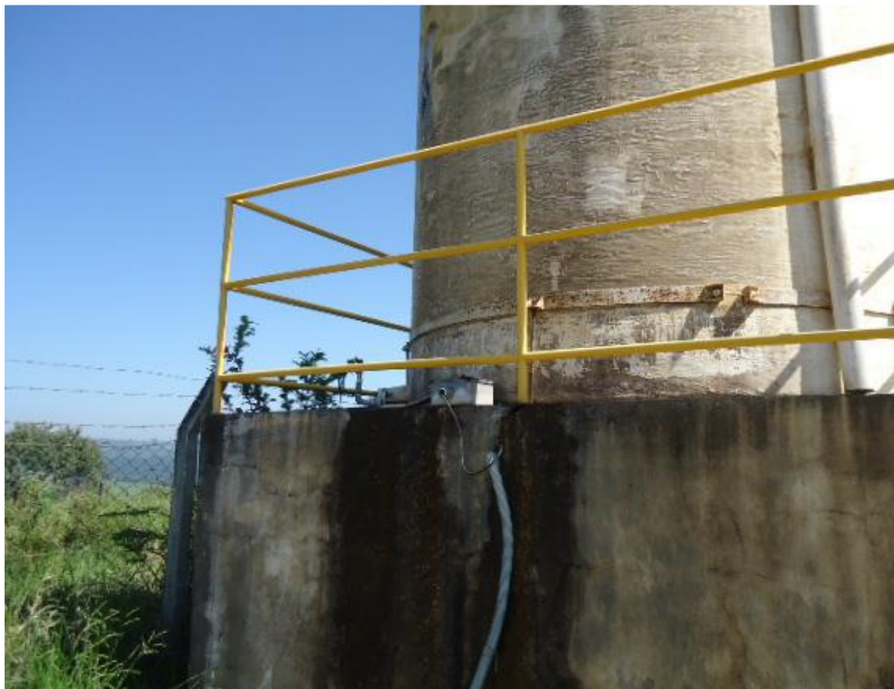
Reservatório Vale Verde com vazamento na flange Cabreúva – SP/2016
